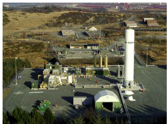
Snurrevarden LNG plant, Norway.
